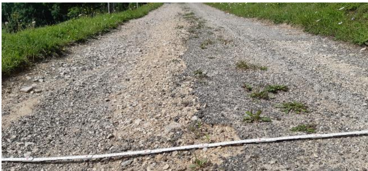
Exemple des défauts présents sur la desserte. Photo Ilex 08.2021
